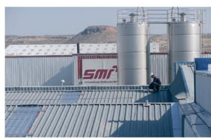
Líneas de vida y mantenimiento de cubiertas
